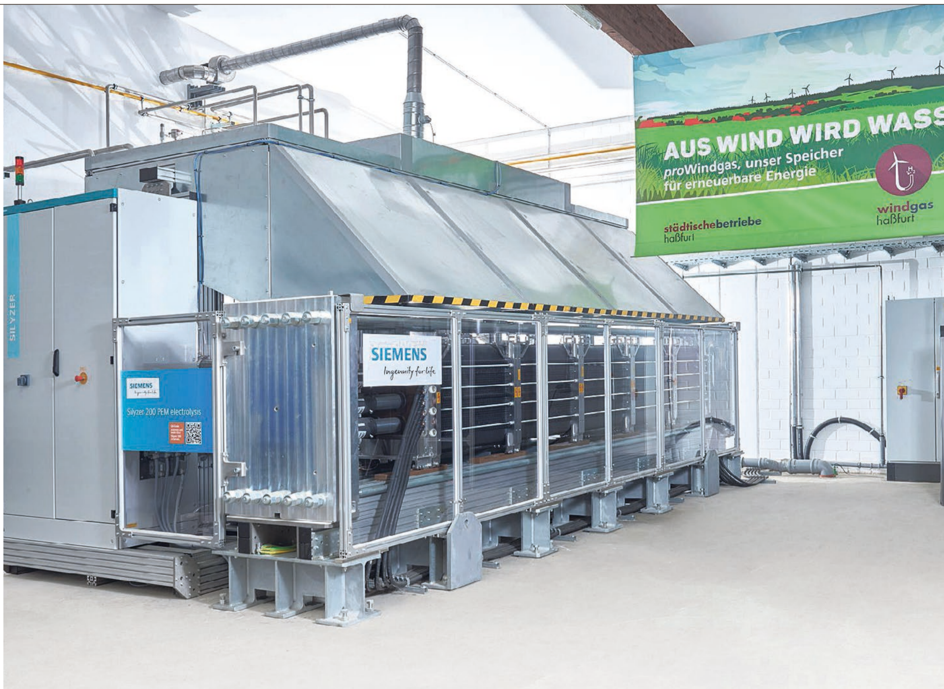
In diesem Elektrolyseur des Stadtwerks Haßfurt wird mit überschüssigem Windstrom Wasserstoff erzeugt, der ins Gasnetz eingespeist werden kann.
